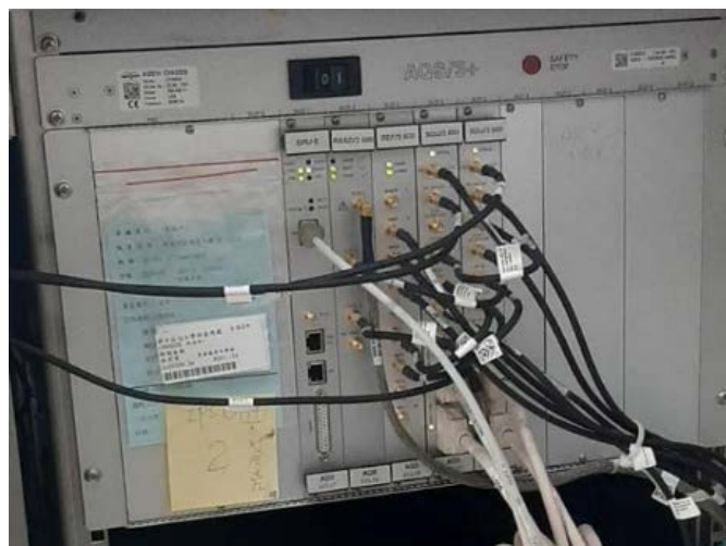
圖十六、600NMR 接收單元機櫃。
